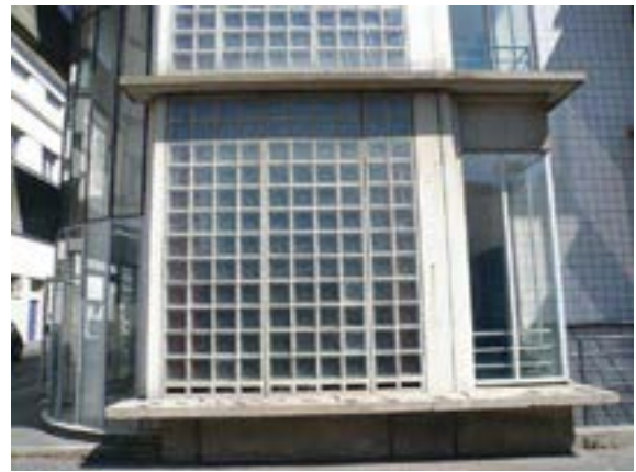
Détail du panneau de briques de verre. Département de la Seine-Saint-Denis, DCPSL, SPC
