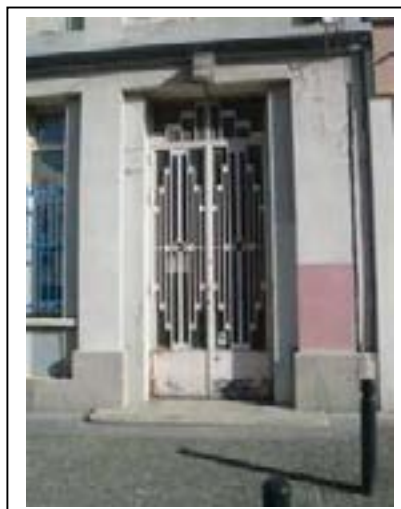
L'une des portes métalliques avec ses ferrogeries très caractéristiques Département de la Seine-Saint-Denis, DCPSL, SPC
