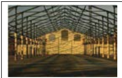
Ossature mise à nu pendant le chantier. Département de la Seine-Saint-Denis, DCPSL, SPC
