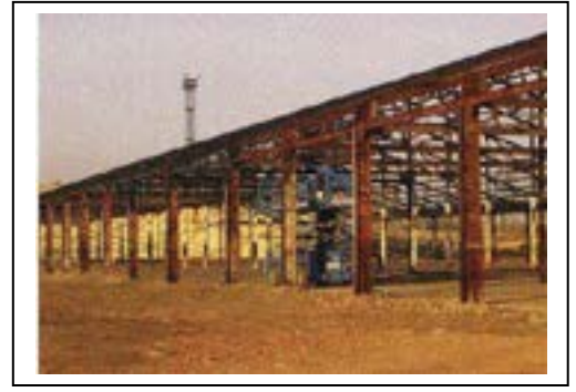
Structure extérieure mise à nu pour le chantier Département de la Seine-Saint-Denis, DCPSL, SPC
