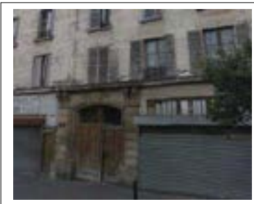
Immeuble, 123 avenue du Président Wilson : détail de la porte cochère de son encadrement, du bandeau à larmier du RDC et quelques persiennes en bois d'origine conservées. Département de la Seine-Saint-Denis, DCPSL, SPC
