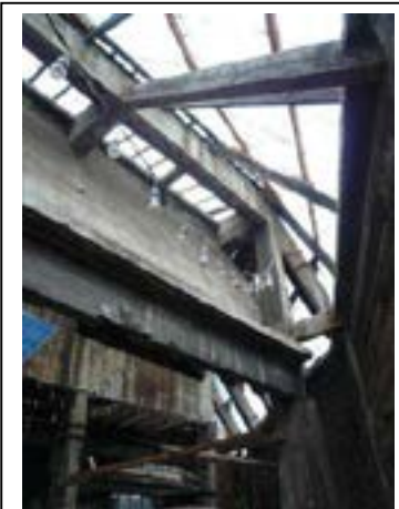
Structure en béton armé et éclairage de l'atelier du casse fonte. Département de la Seine-Saint-Denis
